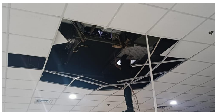
Gambar 3 1 Atap tenant roboh
