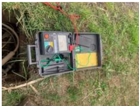
Gambar 2. Pengukuran Ketahanan Isolasi
