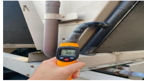
Gambar 5 Suhu yang keluar dari kondensor dengan 5 motor fan 30.5 °C
