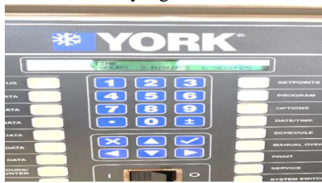
Gambar 9 Waktu yang dibutuhkan Chiller 5
