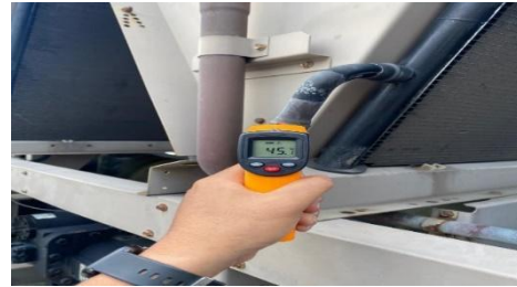
Gambar 6 Suhu yang keluar dari kondensor dengan 4 motor fan 45.7 °C
