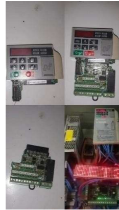
Gambar 4. Kerusakan Pada Modul Inverter
