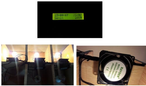
Gambar 19. Kondisi Hanya Beban AC dan Lampu Koridor Menyala
