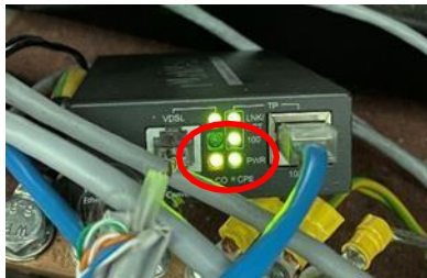
VDSL (CO Mode) di Gedung TX Sumber : Dokumentasi Penulis
